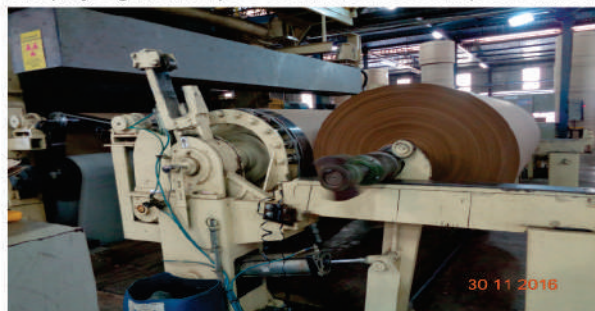
Proteção mecânica fixa proteção de perímetro da enroladeira
